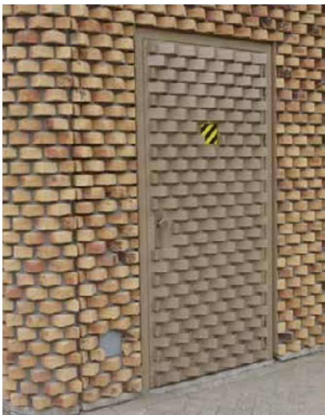
Installaties zijn onderdeel van de gevel
